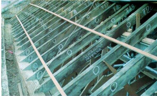
IDENTIFICAÇÃO DE CAIBROS INFESTADOS
