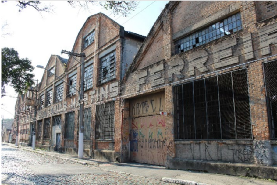
Figura 5: Galpões da antiga Metalúrgica Martins Ferreira, conjunto tombado pelo Conpresp, mas exemplo de edifício que se tornou obsoleto, sofrendo degradações ao longo do tempo.
