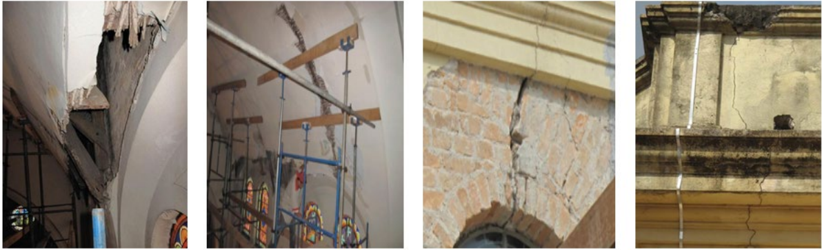
Figura 3: a e b) Escoramento do forro da nave central, c e d) Patologias grandes: no arco de tijolos e na viga superior. Fonte: ASSOCIAÇÃO CULTURAL DE SANTO AMARO, 2013, p.2 e 3.
