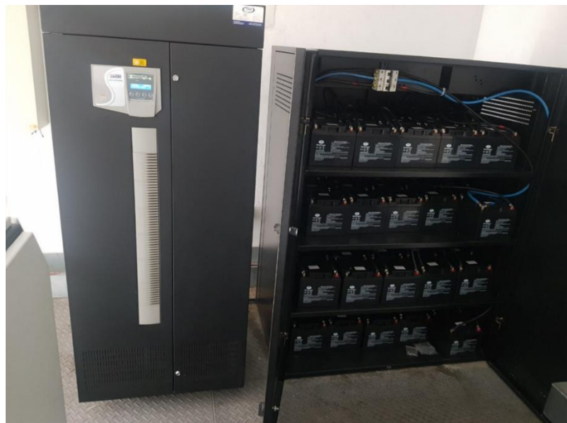
Figura 7: No-break com banco de baterias
